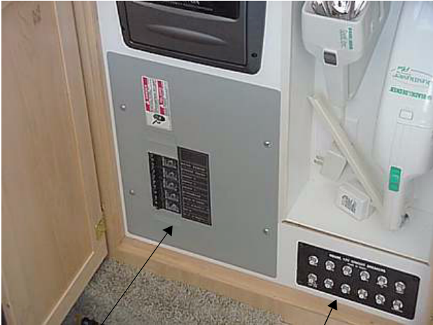
110-Volt AC Breakers
